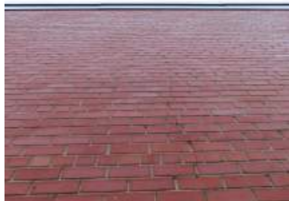
Cochrane Powerhouse - B201021
