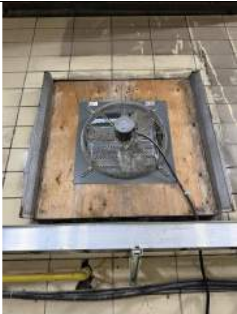
Picture 3.6 - Existing exhaust fan
