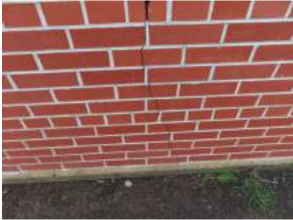
Cochrane Powerhouse - B201021
